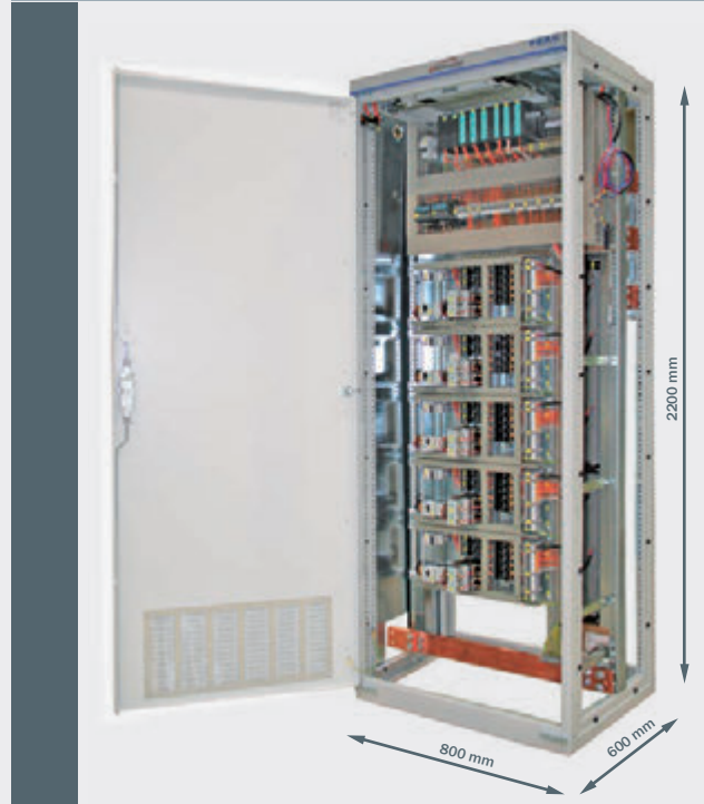
F1: Abgangsfeld mit MCC-Funktionsbaugruppen in Modultechnik
